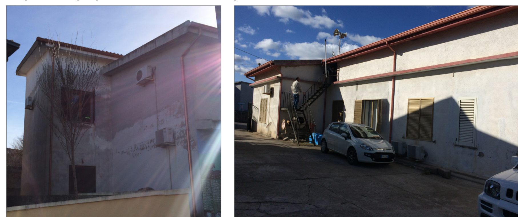
Prospetto sud e prospetto est- Fenomeni di erosione - perdita cromatica dello strato di finitura
