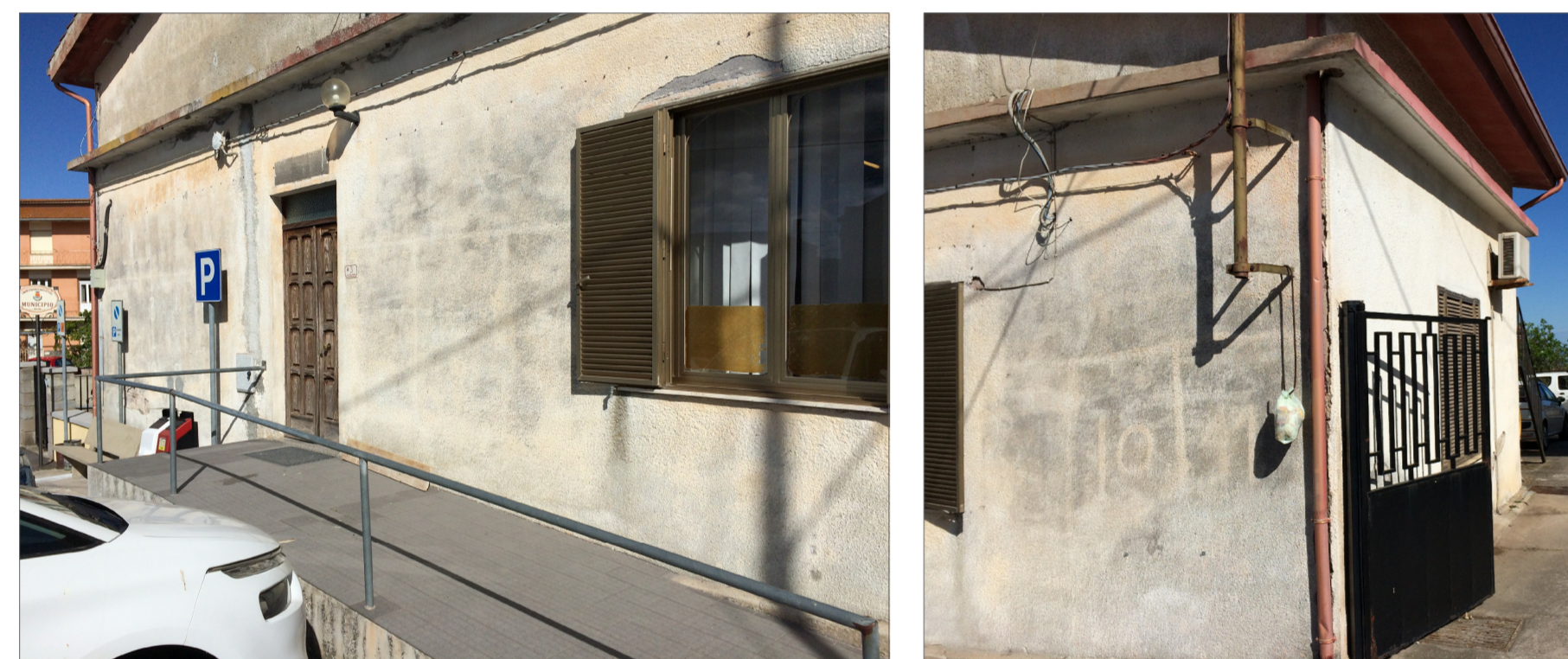
Prospetto sud Fenomeni di erosione - perdita cromatica dello strato di finitura - Fenomeni di distacco dell'intonaco
