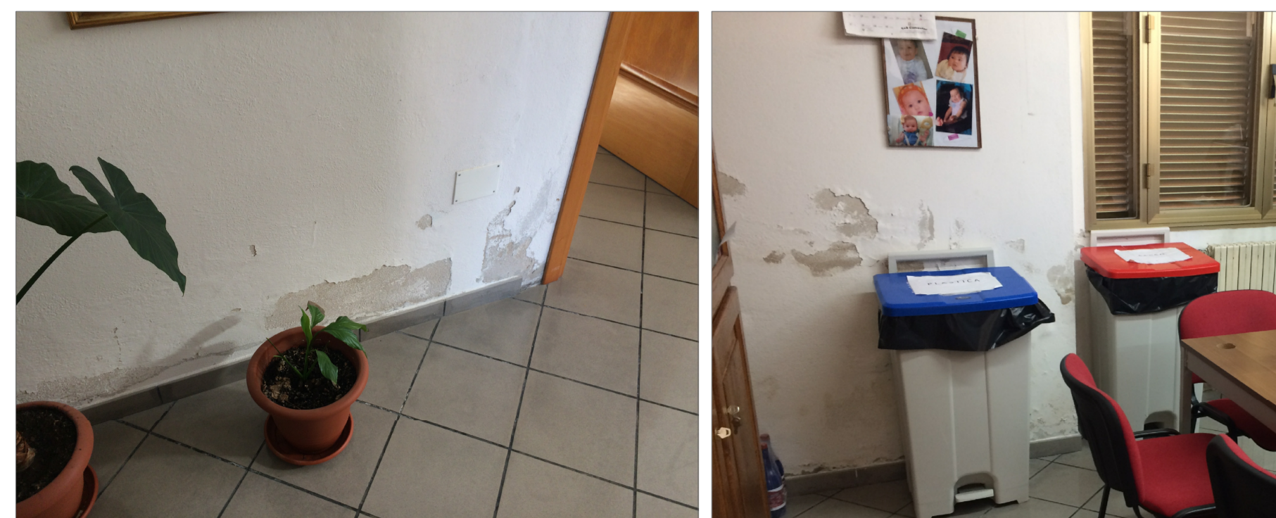
Prospetto nord e prospetto est- Fenomeni di erosione - perdita cromatica dello strato di finitura
